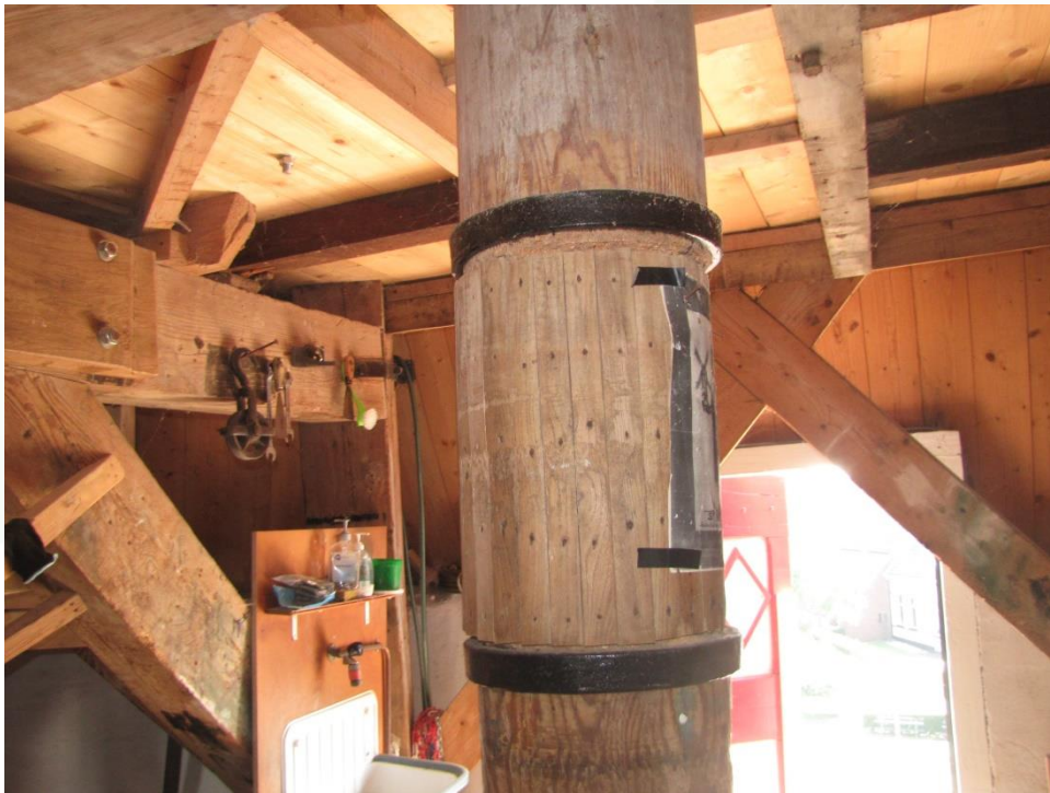
Figuur 62 De spil van de naloper is flink ingesleten door de aandrijfriem naar de zeverij.
