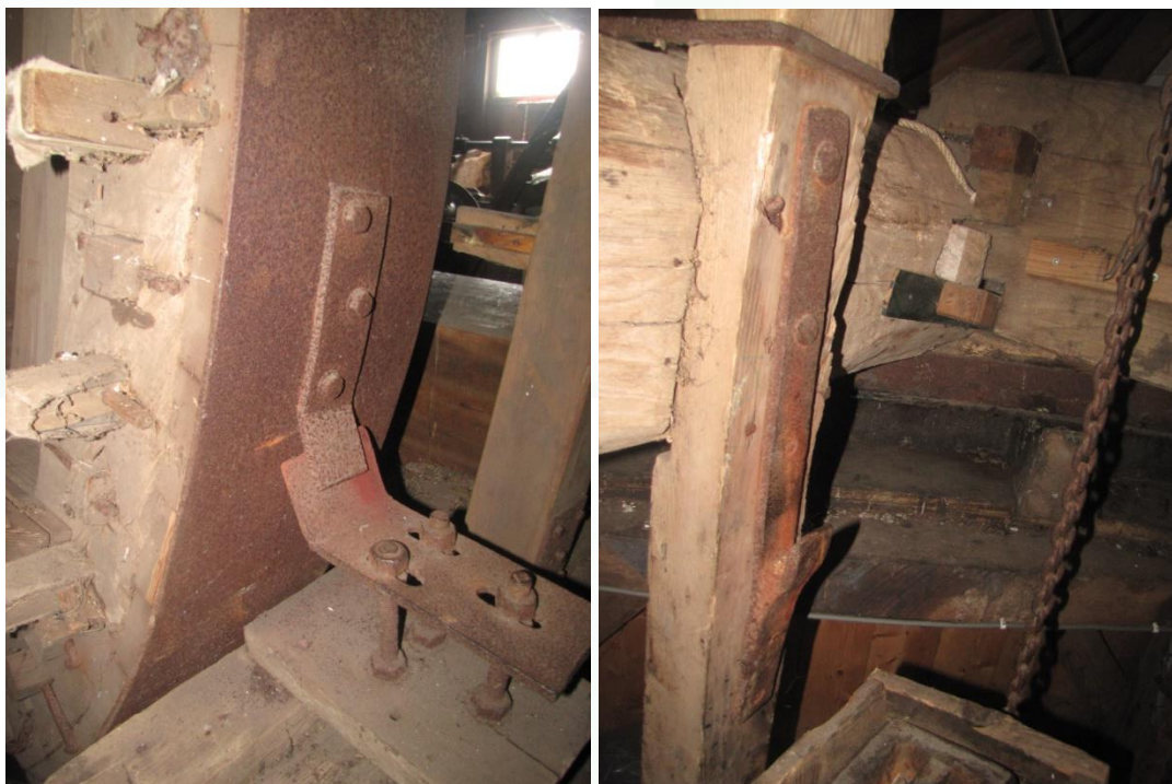
Figuur 36 Zelfs de rust en rijklamp zijn van staal. De achterste hanger of strijker is nog wel oud. Waarschijnlijk is de stalen vang aangebracht door molenmaker Bremer die veel molens van dit soort vangconstructies heeft voorzien ter vervanging van de oorspronkelijke houten vangstukken.
