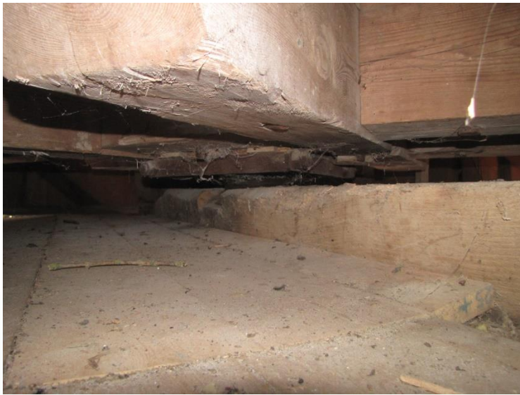
Figuur 45 Lagering spil op de dons balk, welke is opgelegd op de losse binten van de middelste kruisbalken. Bij oplegging op de vaste binten had de spil verder door het takrad kunnen steken.
