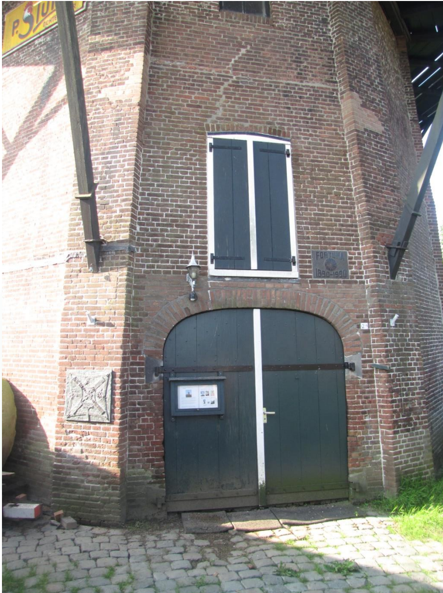
Figuur 19 Achtkante onderbouw met hoekpilasters. Diverse reparaties aan het metselwerk zijn zichtbaar, waaronder het vervangen van de latei door een boog.
