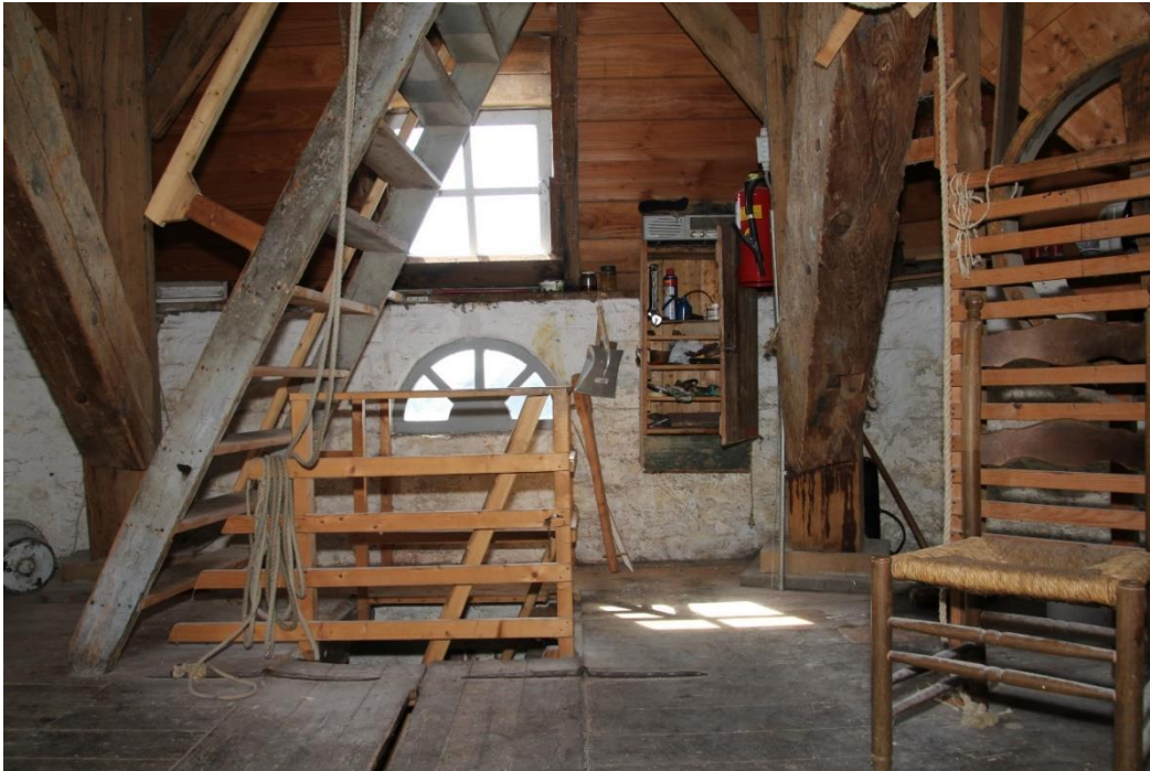
Afbeelding 4.46: De stellingzolder, met het trapgat naar de onderliggende wanzolder en de trap naar de bovenliggende steenzolder.
