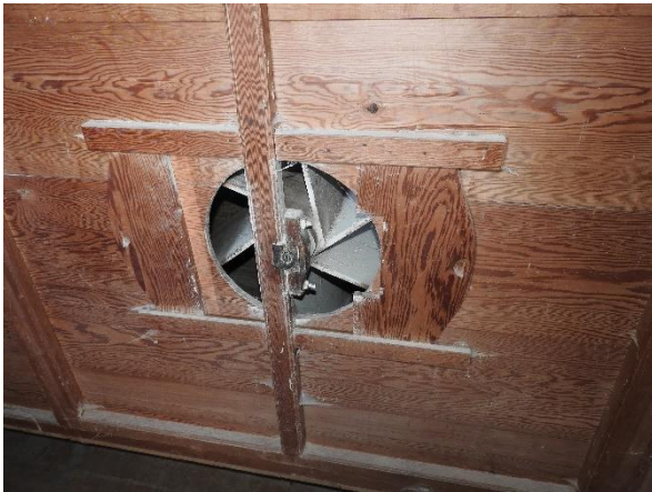
Afbeelding 4.43: Detail van de schoepen van de wanmolen. Foto genomen aan de achterzijde van de wanmolen.
