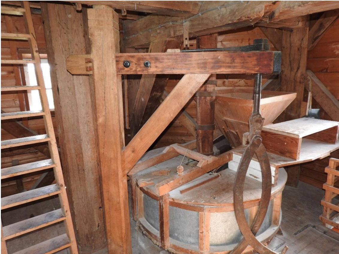
Afbeelding 4.62: De steenzolder met steenkraan en koppel maalstenen met rechts achter de kaar. De steenkraan is een takel die wordt gebruikt om de molenstenen te hijsen en te keren, zodat ze gescherpt of vervangen kunnen worden. 20 De huidige staander van de steenkraan is nieuw; de oude staander van de steenkraan staat elders op de steenzolder. De steenkuip is van blikken beplating.
