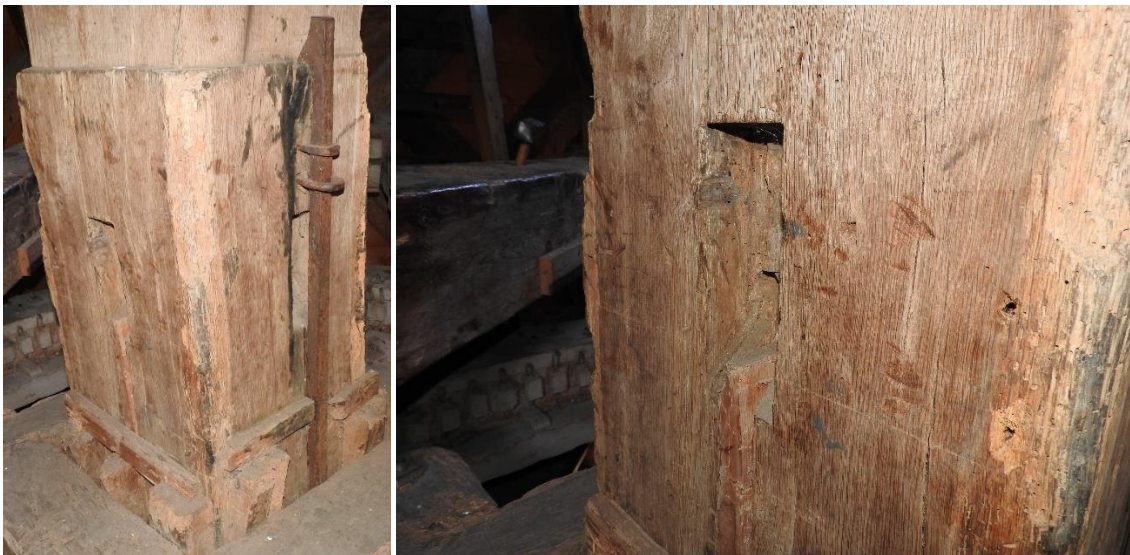
Afbeeldingen 4.84 en 4.85: De kepen in de standerd van de standermolen uit Niekerk, waarin de steekbanden waren geplaatst die de standerd rechtop hielden.
