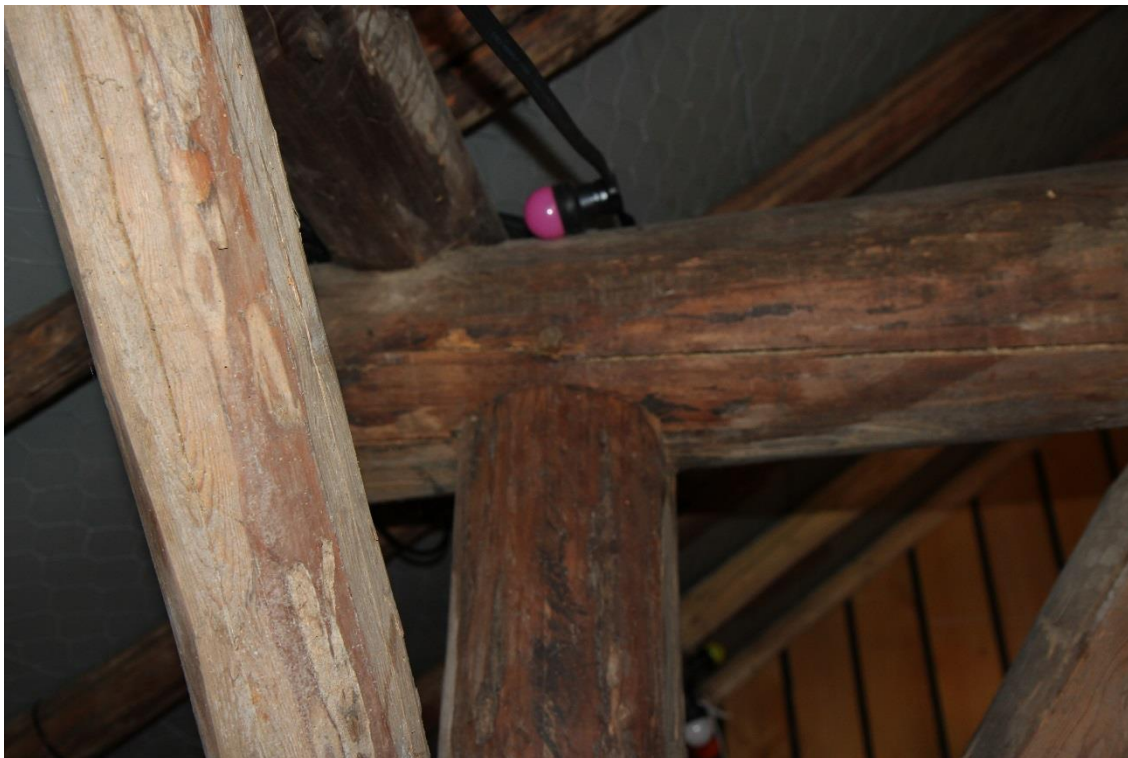
9. Detail van de houtconstructie in de schuur. Bemerk het kippengaas tegen de isolatieplaten.
