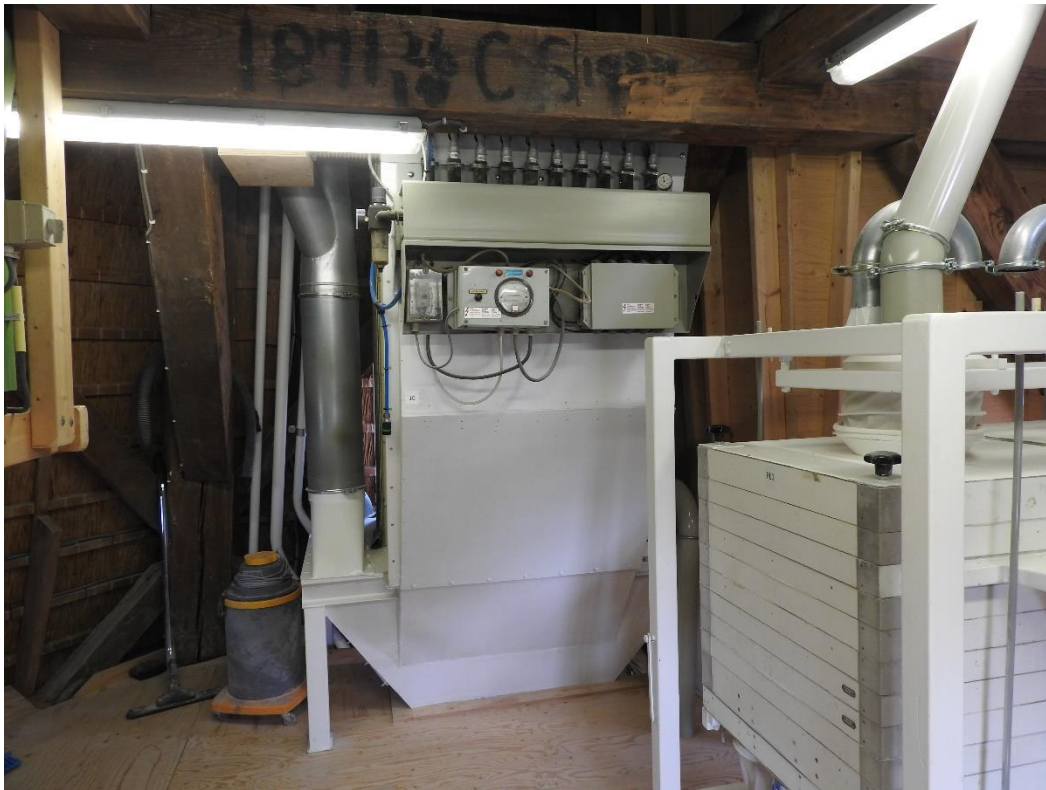
Afbeelding 4.26: De centrale afzuiging voor het afzuigen van alle machines, maalkoppels e.d. De lucht gaat door een viertal roosters, de uitblaas, ter plaatse van de tweede zolder, waar een kistraam hiervoor aangepast is.
