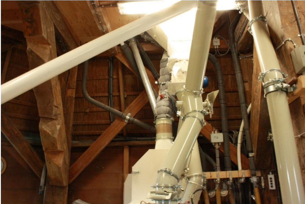
Afbeelding 4.21: De buizen voor het transport van het graan op de begane grond.
