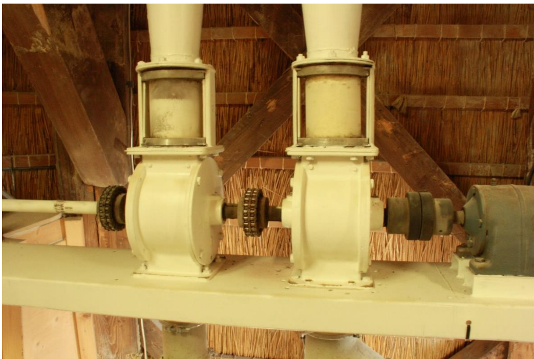
Afbeelding 4.40: Twee sluizen (doorval/doorblaassluizen) voor het transport van meel op de luizolder.
