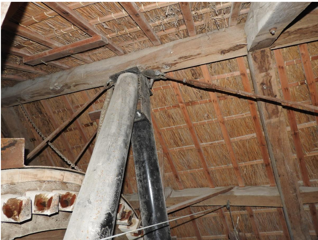
Afbeelding 4.41 en 4.42: De bovenas (rechts) met het bovenwiel (links) op de kapzolder. Op de kapzolder is in het midden van de lange spruit een constructie van twee staande stalen buizen (zie boven) aangebracht, met twee trekstangen naar de windpeluw aan beide zijden van de as (zie onder links) en één trekstang helemaal aan de bovenzijde van de staart (zie onder rechts). Deze constructie is aangebracht om het doorbuigen van de voeghouten te voorkomen.
