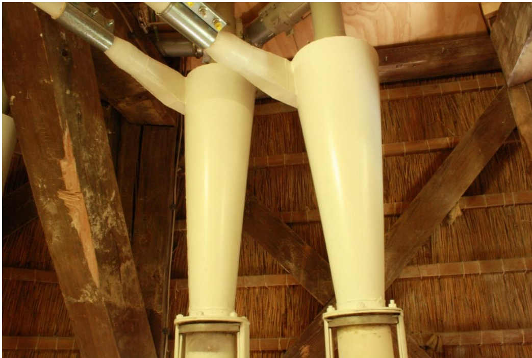
Afbeelding 4.39: Cyclonen (buizen) voor het transport van het meel op de luizolder.
