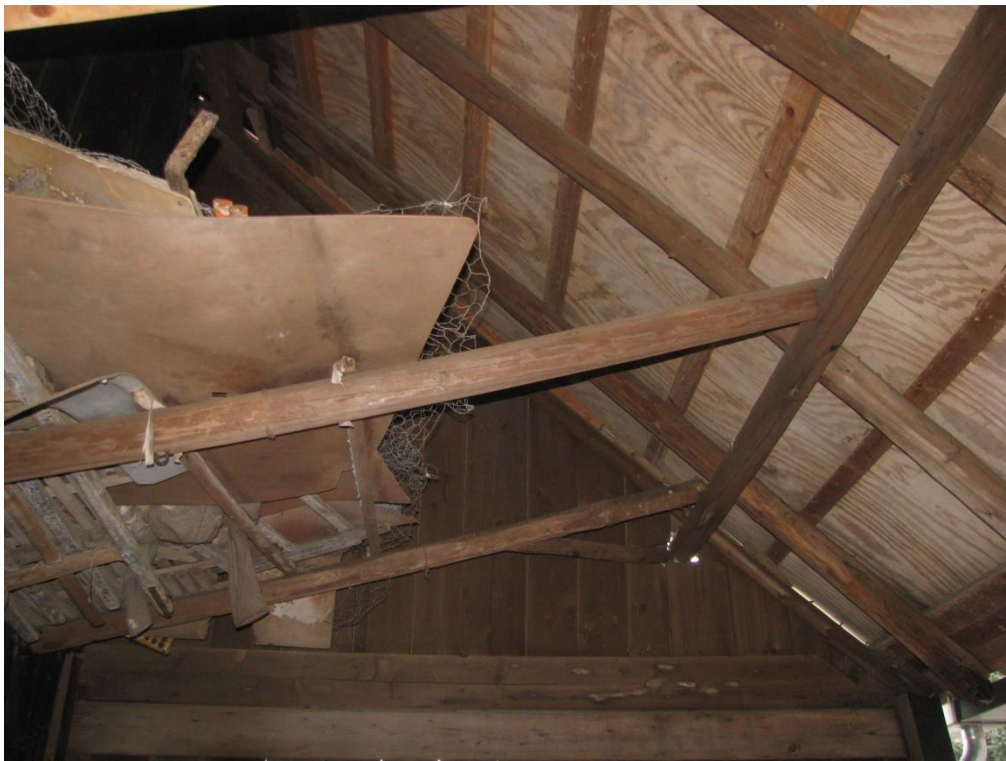
Figuur 45 De luifel aan de linkerkant (westzijde) is al eens helemaal vernieuwd.
