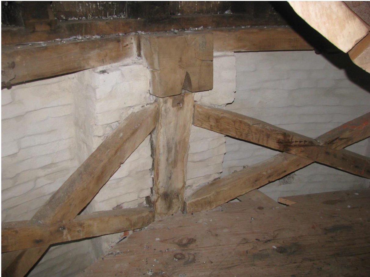
Figuur 16 Op de kapzolder zijn in de muurverzwaringen stijlen, met daarop blokkelen, gemetseld. Tussen de stijlen zijn kruisen aangebracht en in de blokkelen zijn muurplaten gekeept met daarop de neutring.
