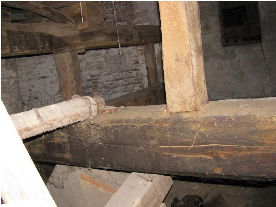
Figuur 22 Van de bovenste balklaag (van de drie onderste) is één kruisbalk doorgezaagd.
