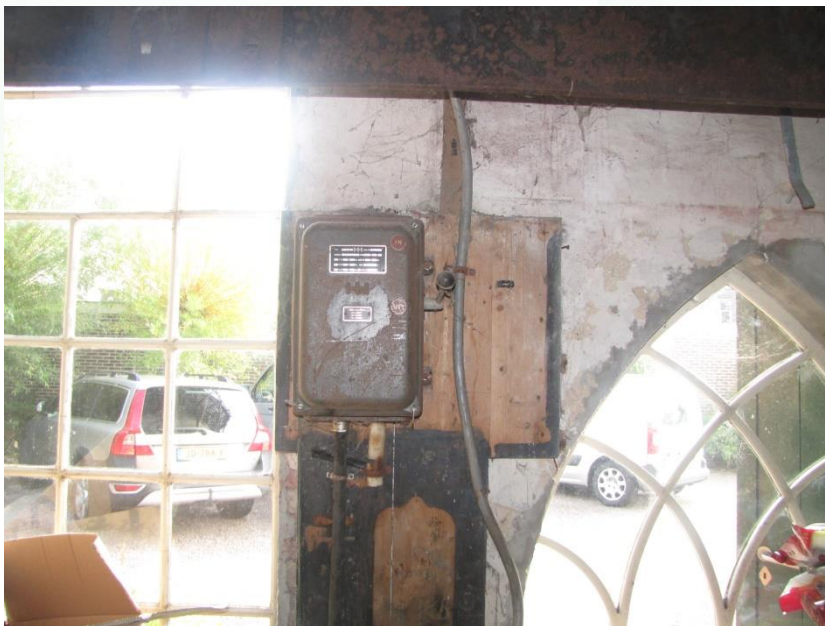
Figuur 73 Schakelaar met nulspanningbeveiliging voor de elektromotor in de machinekamer.
