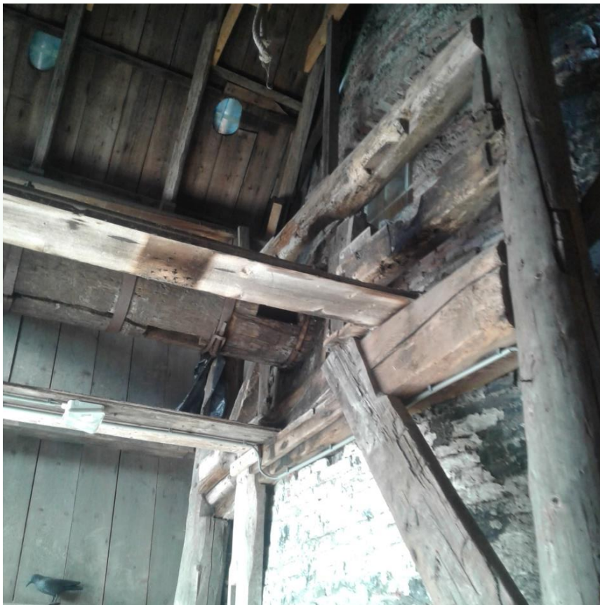
Figuur 43 In het dakhout zijn diverse gaten gemaakt voor het afvoeren van de rook van de vuisters (zie ook figuur 41).
