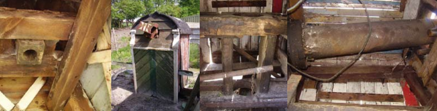
V.L.N.R. DE ONDERTOREN MET ZETEL EN KOKER; DE VIERKANTE ONDERKANT VAN DE KOKER; HET BOVENHUIS; VAN OPZIJ IN HET BOVENHUIS GEKEKEN (ONDER, MET DE KETTING, DE "VANGBALK"); BOVENAS MET LINKS DE AUTO-REMTROMMEL EN RECHTS DE HALS-ROLLAGERS FOTO'S: MARCEL DUURSMa, PIETERBUREN
