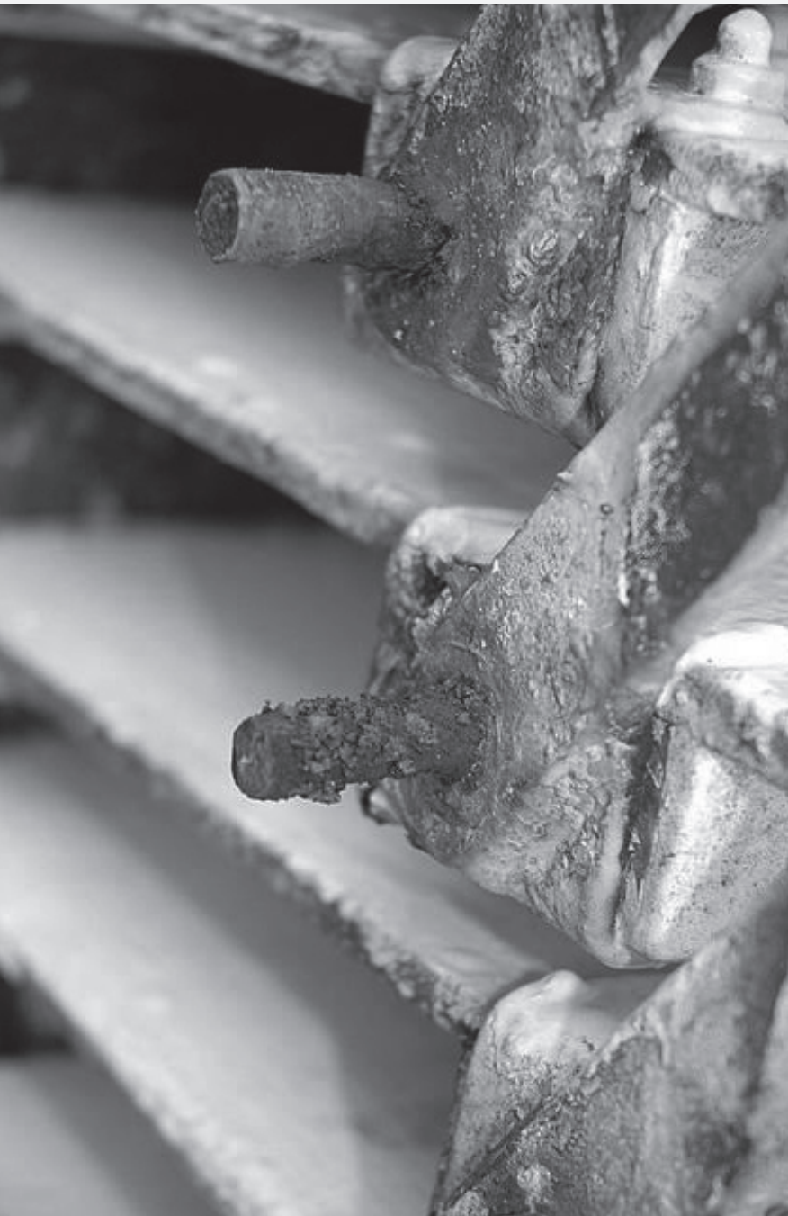
CORROSIE VAN DE DRAAIPUNTEN VAN DE KLEPPEN FOTO: J.J. SCHUURMAN
